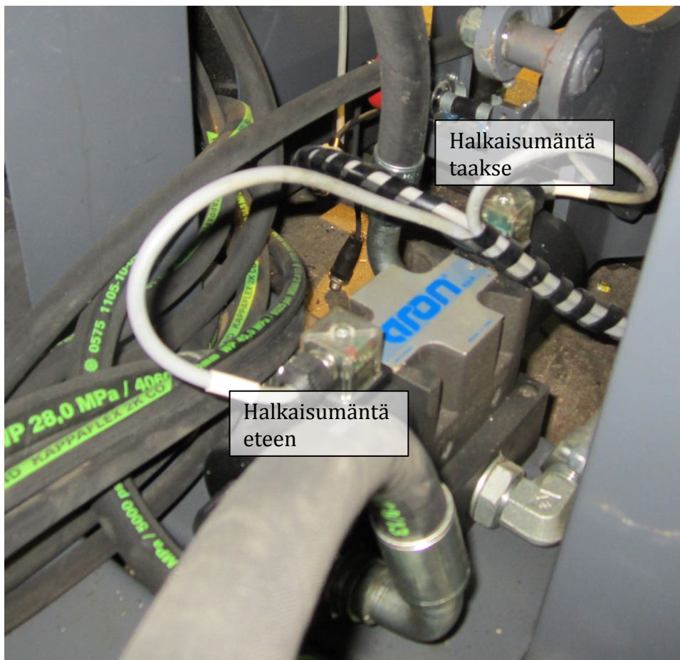
Halkaisusylinterin venttiili sähkökeskuksen takana.
